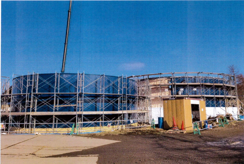
1年間かけてバイオガス発電設備（写真）などを整備する（北海道釧路市、阿寒マイクログリッド提供）
